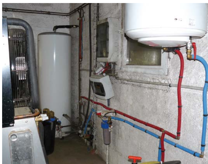
Situé entre le récupérateur et le chauffe-eau, le ballon de stockage doit être bien dimensionné
