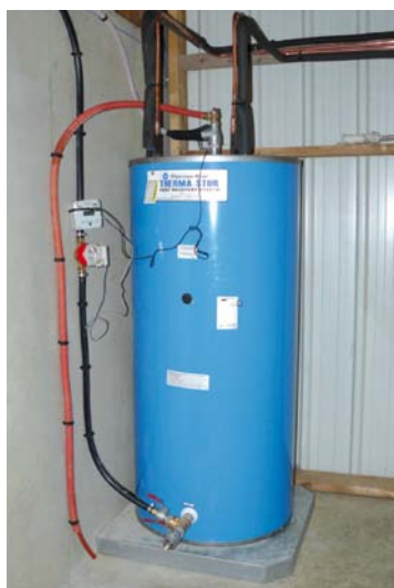
Récupérateur de chaleur interne
